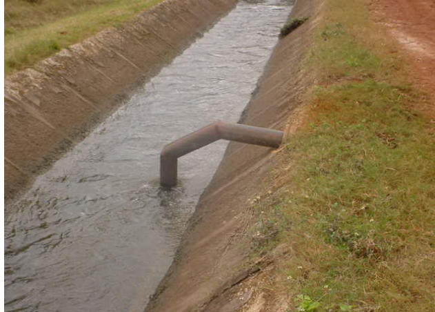
Sifón Rustico construido por los clientes, obsérvese las perforaciones en el talud del canal
